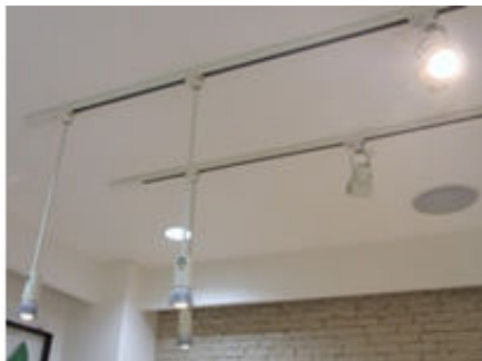
配線ダクトからの吊り下げ
