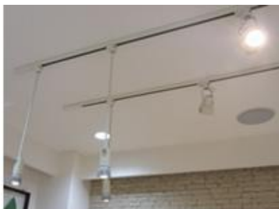
配線ダクトからの吊り下げ
